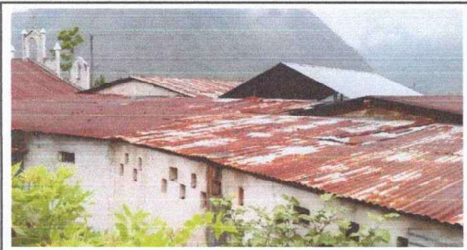
Foto1: Cubierta de lámina de aulas con alto grado de corrosión.
