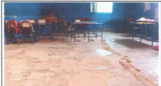
Foto 4: Deterioro de piso de cemento en el interior de las aulas.
